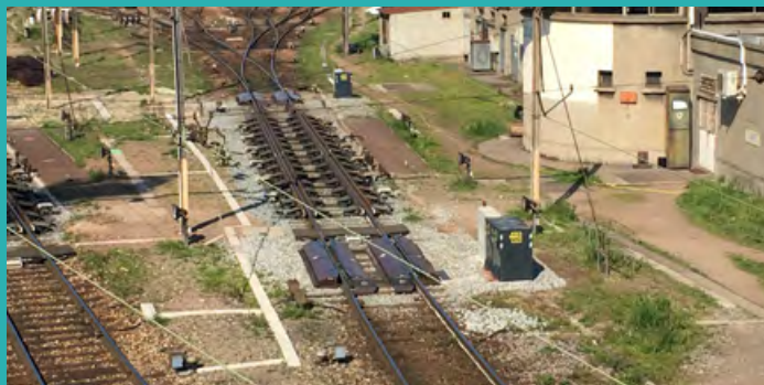
Système de freinage de voies de la gare de triage du Bourget à Drancy.
